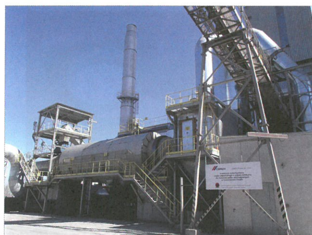
Rys.4. Suszarnia paliw alternatywnych w Zakładzie Cementownia Chełm – CEMEX Sp. z o.o. Fot.: CEMEX Sp. z o.o.
