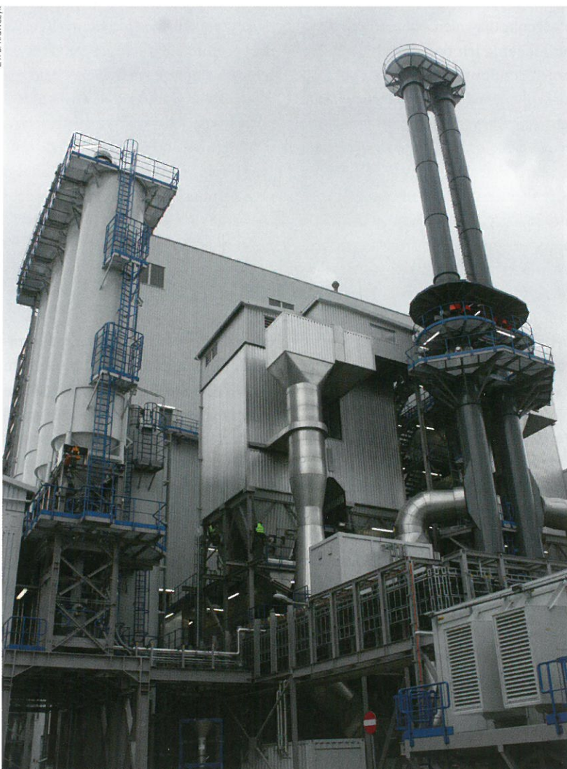
Realizacja poznańskiej Instalacji Termicznego Przekształcania Odpadów Komunalnych (ITPOK) jest największym działaniem proekologicznym w mieście w ostatnich latach
