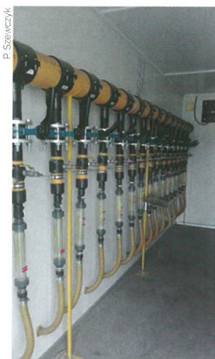
Stacja zbiorcza pozyskiwania biogazu na składowisku w ZUOK-u „Orli Staw”
